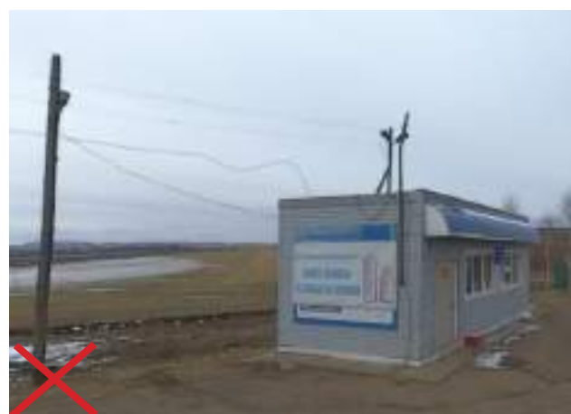
Недопустимо устраивать освещение с помощью прожектора на деревянной опоре и стойке на павильоне.
